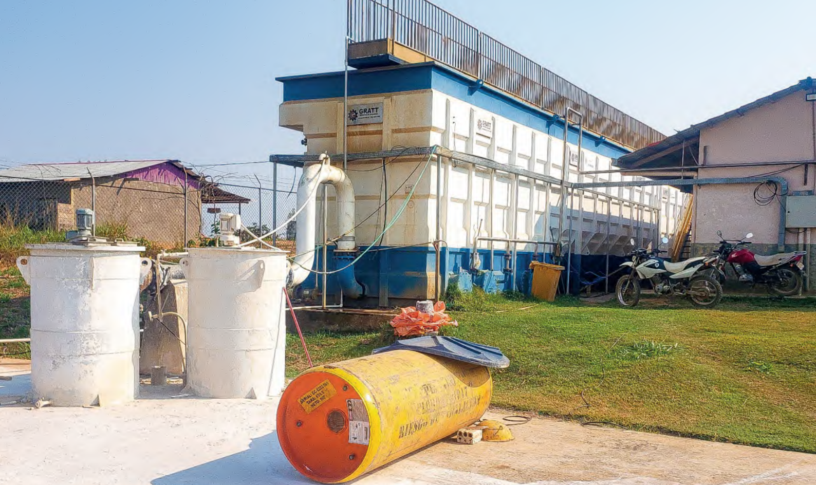
PPA Villa Busch (tipo compacta), EPSA COBIJA, Pando
