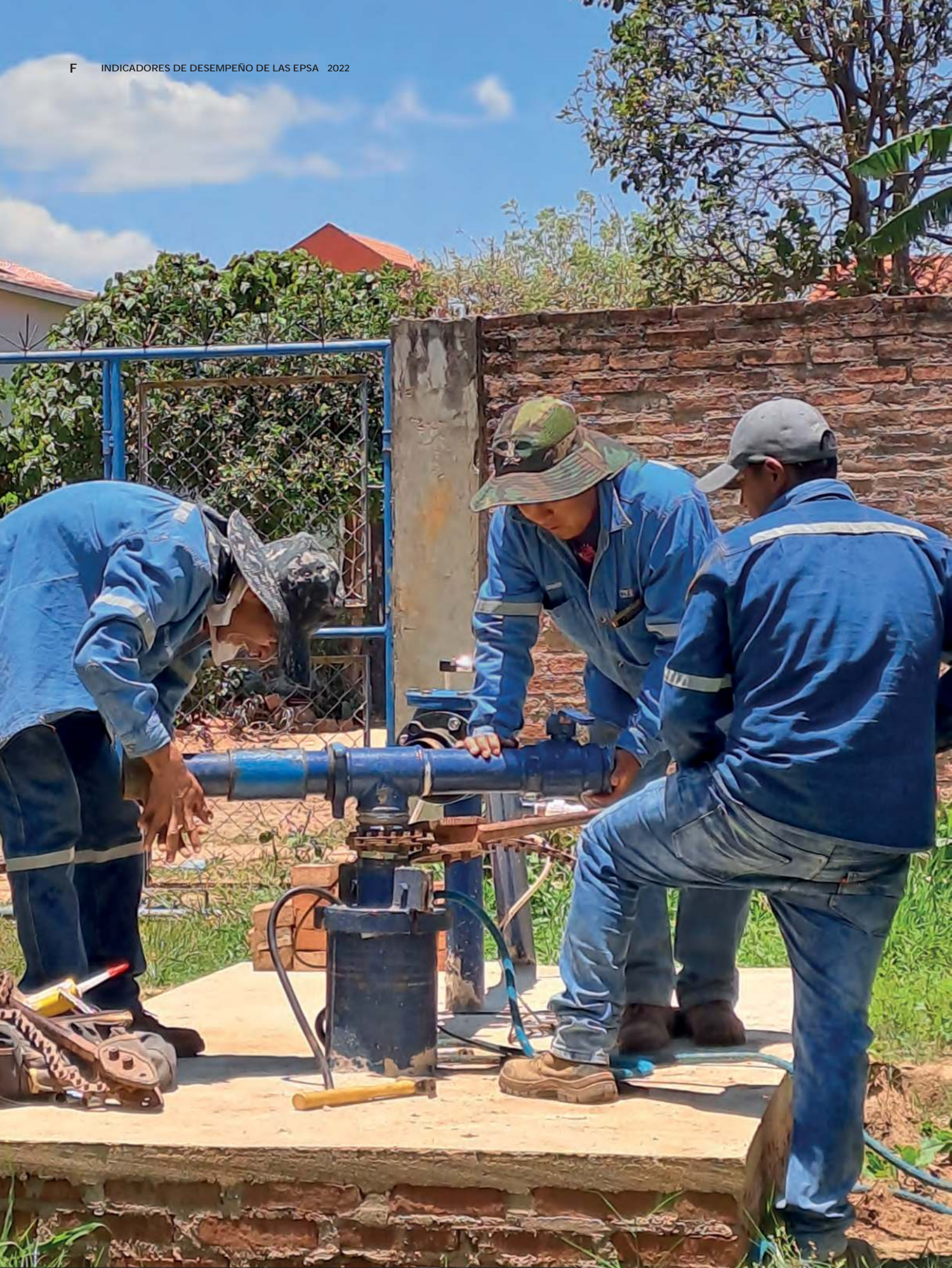
Foto: Mantenimiento de la línea de impulsión de pozo, COSIMBO (Santa Cruz).
